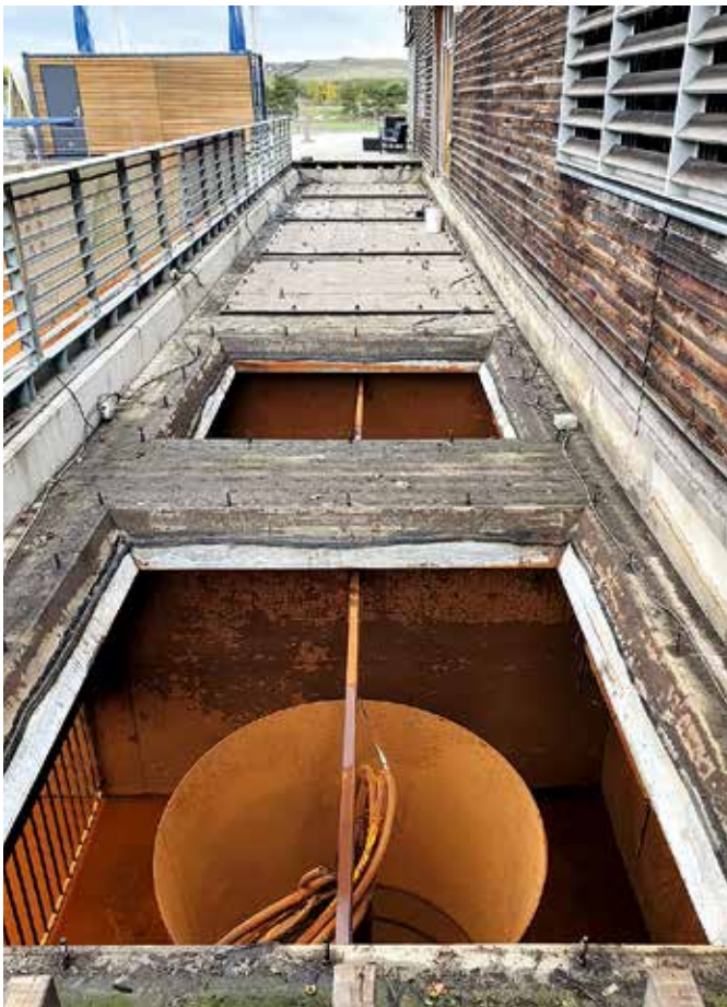
Blick auf eine Pumpe nach der Demontage des Terrassenbelages.
